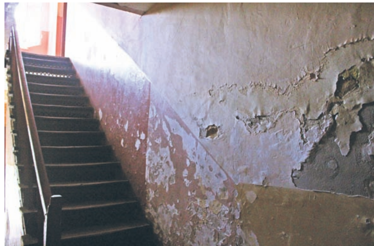
Klatka przy Norwida 2 jest w opłakanym stanie.
